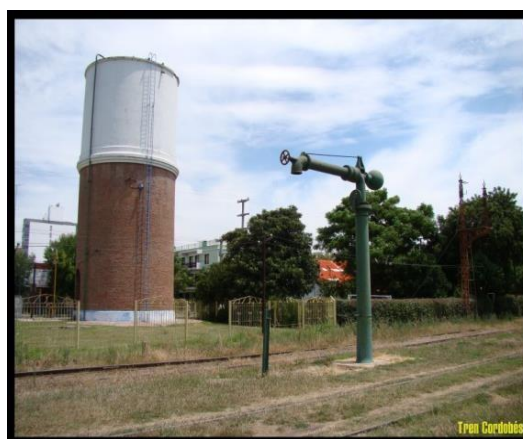
Cañería para cargar agua de locomotora https://www.trencordobes.com.ar/?cat*20
